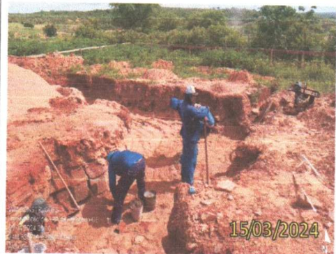
FOTO 4.18 – VISTA PERSPECTIVA DA ESCAVAÇÃO E REGULARIZAÇÃO DO SOLO DO POÇO DE SUÇÃO.
