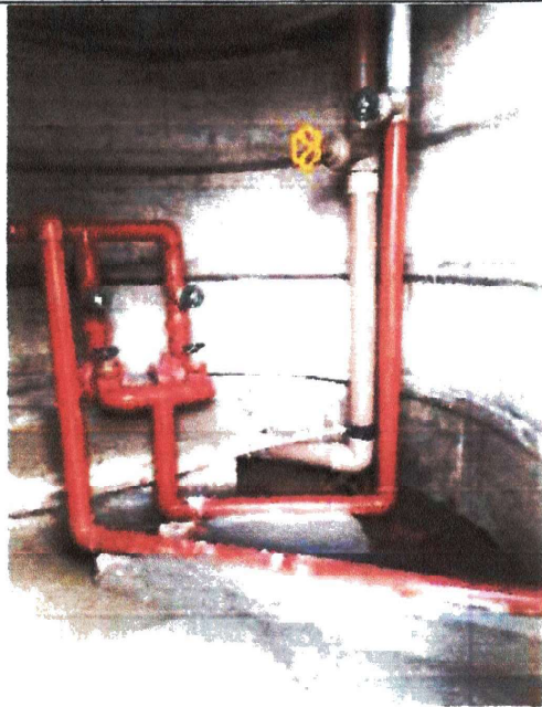
INSTALAÇÃO DE COMBATE A INCÊNDIO
