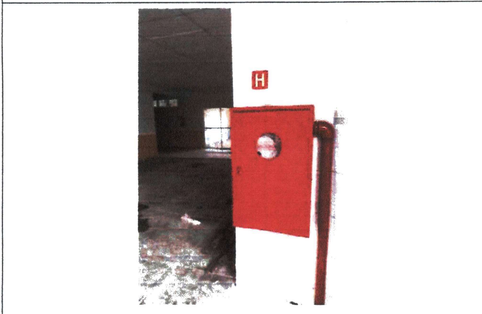
INSTALAÇÃO DE COMBATE A INCÊNDIO
