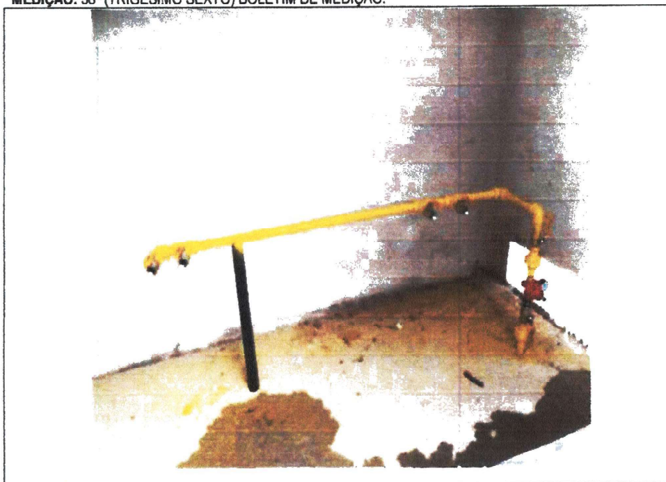
INSTALAÇÃO DE GÁS
