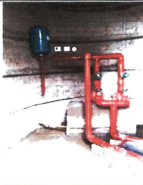
INSTALAÇÃO DE COMBATE A INCÊNDIO
