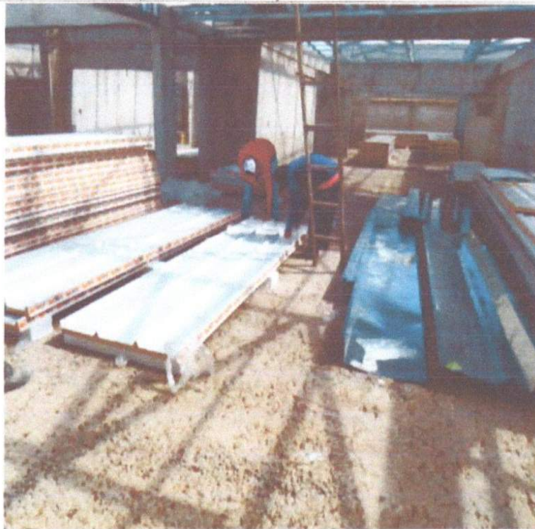
SERVIÇO DE PREPARAÇÃO DAS TELHAS PARA MONTAGEM – COLOCAÇÃO DA FITA TACKY TAPE.
