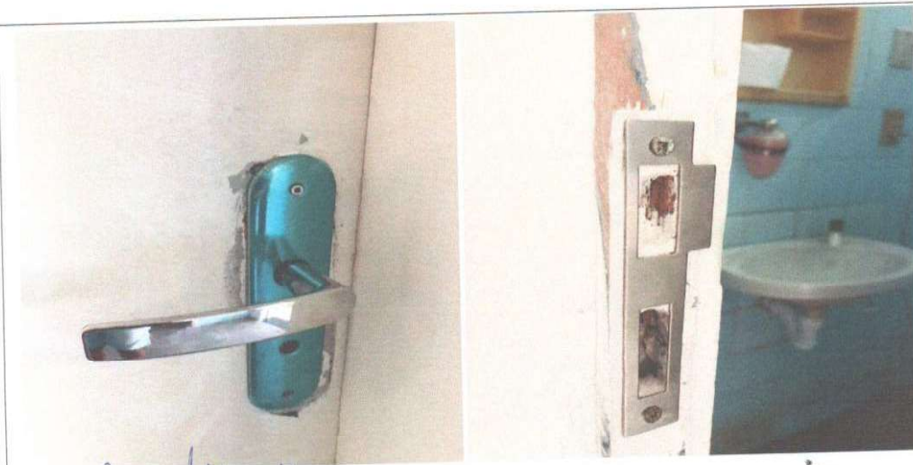
Fechaduras a ser trocadas.
