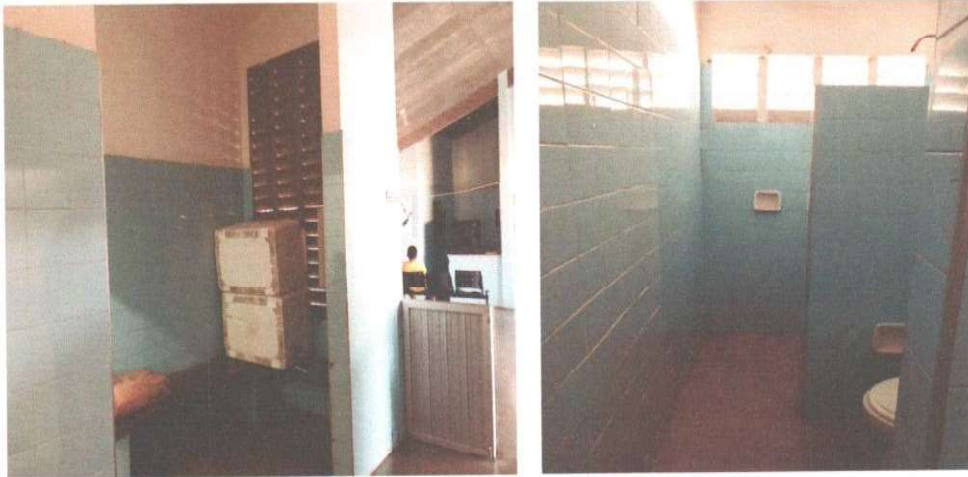
Cobogós a serem fechados com gesso acartonado.
