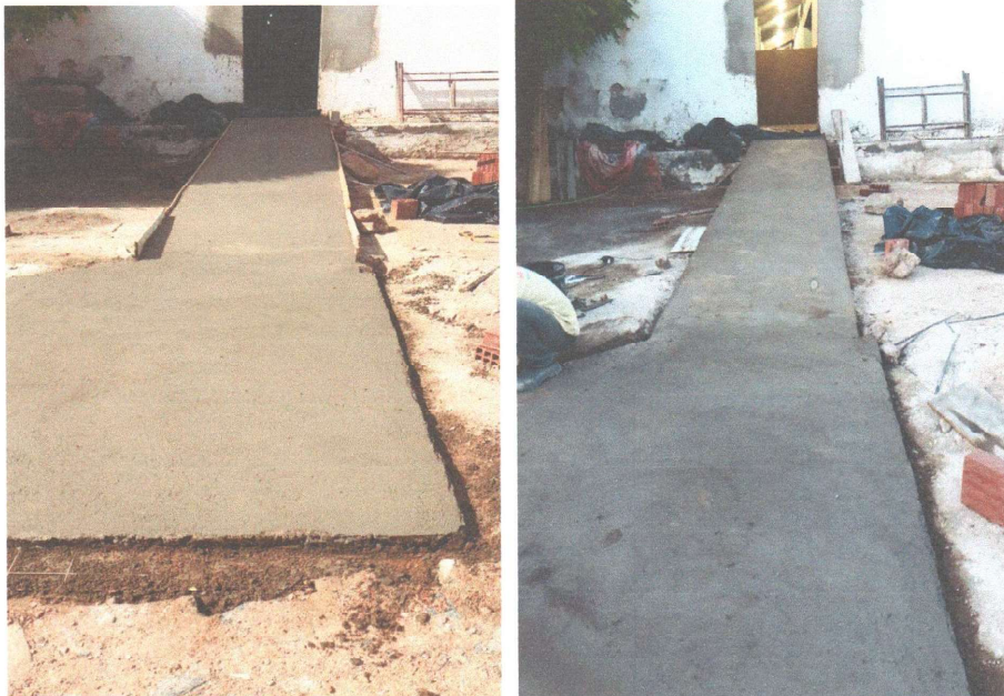
Local a ser locado o corrimão.
