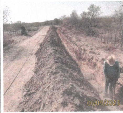
FOTO 1.34 – VISTA FRONTAL DA ESCAVAÇÃO DA VALA COM AUXÍLIO DO ROMPEDOR PNEUMÁTICO MANUAL.
