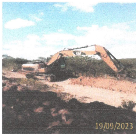
FOTO 1.45 – VISTA EM PERSPECTIVA DA ESCAVAÇÃO EM ROCHA BRANDA A FRIO COM AUXÍLIO DA ESCAVADEIRA HIDRÁULICA E ROMPEDOR ACOPLADO.
