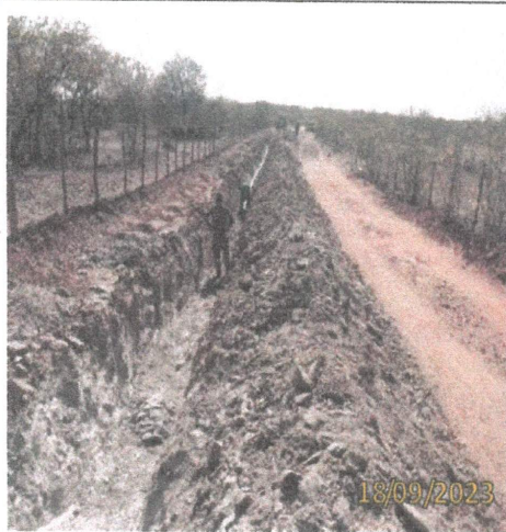
FOTO 1.43 – VISTA DO MATERIAL EM ROCHA A FRIO PARA SER RETIRADO COM O AUXÍLIO DA ESCAVADEIRA HIDRÁULICA E ROMPEDOR ACOPLADO.
