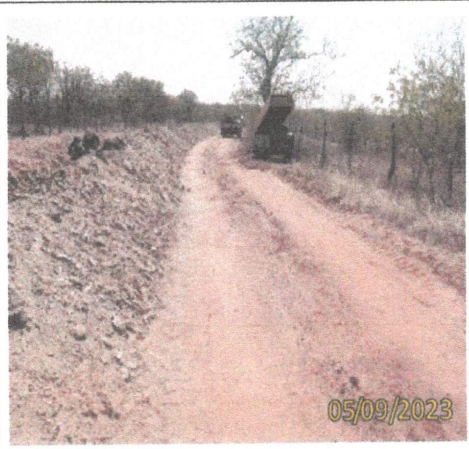
FOTO 1.32 – VISTA EM PERSPECTIVA DO COMPRESSOR PARA A ESCAVAÇÃO EM MATERIAL DE 3ª CATEGORIA.
