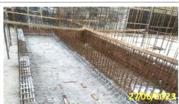
FOTO 3.16 – VISTA EM PERSPECTIVA DA CONCRETAGEM DA LAJE DE FUNDO DO POÇO DE SUÇÃO.
