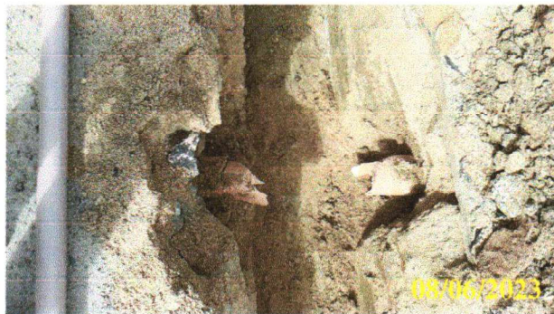
FOTO 2.9 – TUBULAÇÃO DE ESGOTO DANIFICADA.
