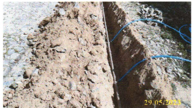
FOTO 3.12 – TUBULAÇÃO COM OS RAMAIS.
