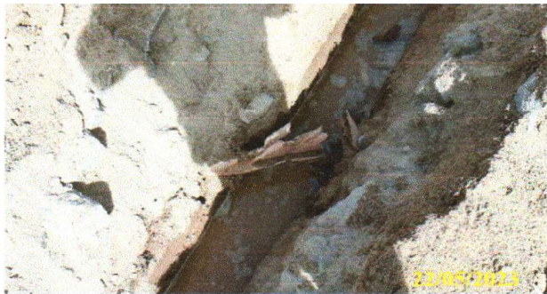
FOTO 3.9 – TUBULAÇÃO DE ESGOTO DANIFICADA
