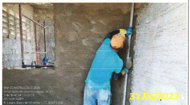
FOTO 1.22 – CORTE NO REBOCO INTERNO DA CASA DE BOMBAS.
