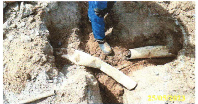
FOTO 3.10 – DETALHAMENTO DAS ESCAVAÇÕES DANIFICANDO A REDE DE ESGOTO.
