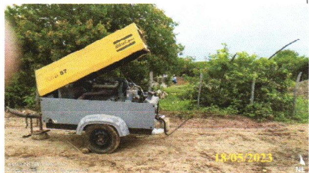
FOTO 6.12 – VISTA LATERAL DO COMPRESSOR..
