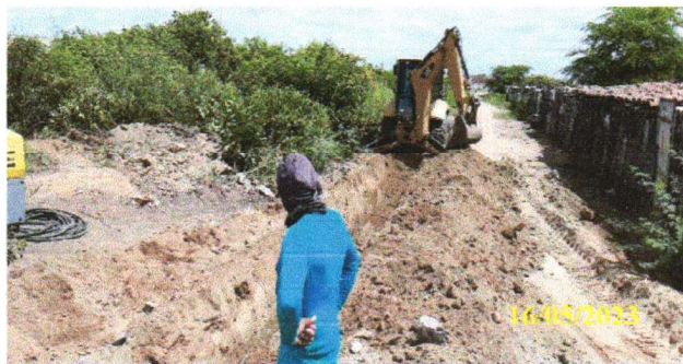
FOTO 6.3 – ESCAVAÇÃO EM MATERIAL DE SEGUNDA E TERCEIRA CATEGORIA COM AUXÍLIO DA RETROESCAVADEIRA
