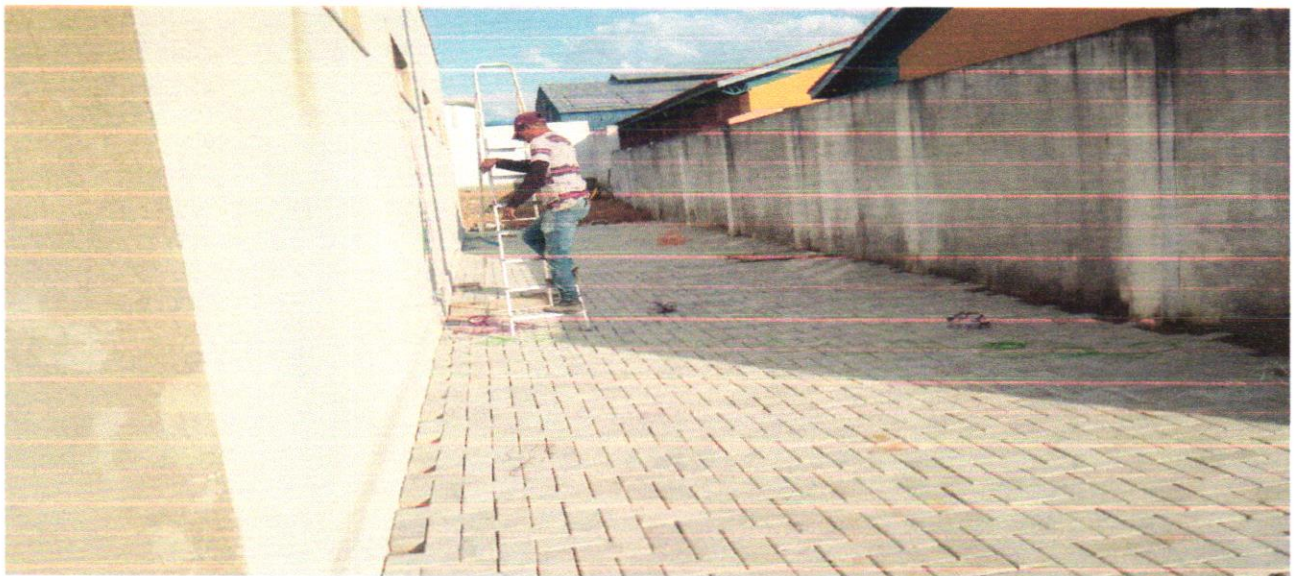
FOTO – 14 –DATA: 19/12/2022 - (INSTALAÇÕES ELÉTRICAS) NA ÁREA DE SECAGEM DE ROUPA) – PASSANDO OS CABOS NAS CAIXAS DE PASSAGEM
