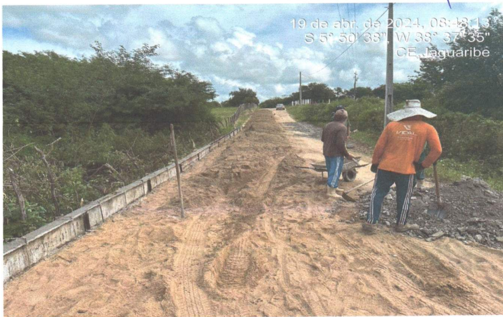
GUIA (MEIO-FIO) E SARJETA CONJUGADOS DE CONCRETO, MOLDADA IN LOCO EM TRECHO CURVO
