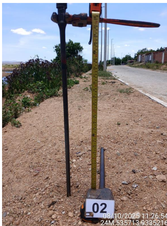
Foto 02 – Material de aterro compactado na base em ST 02. Av. Maria Marta – Revestimento piso intertravado.
