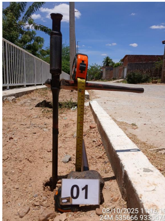
Foto 01 – Material de aterro compactado na base em ST 01. Av. Maria Marta – Revestimento piso intertravado.
