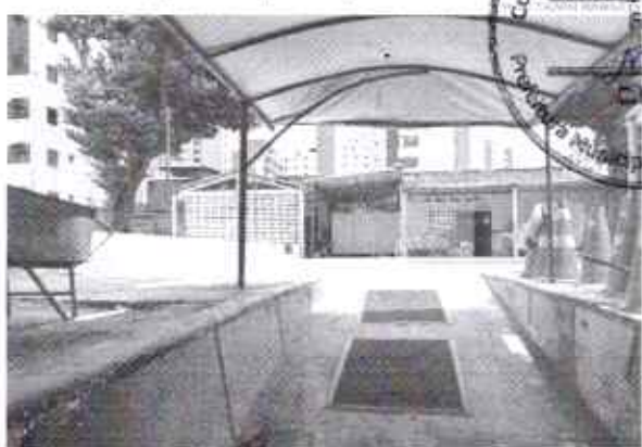
O ponto Anastácio Magalhães tem relatos de rachaduras, infiltrações e falta recorrente de insumos
