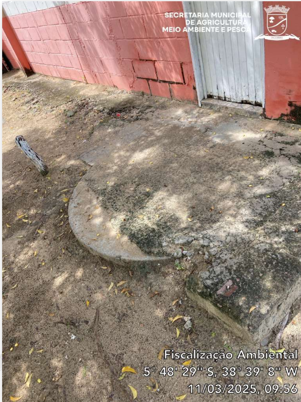
Figura 10 - Fossa séptica da Barraca do Barto
