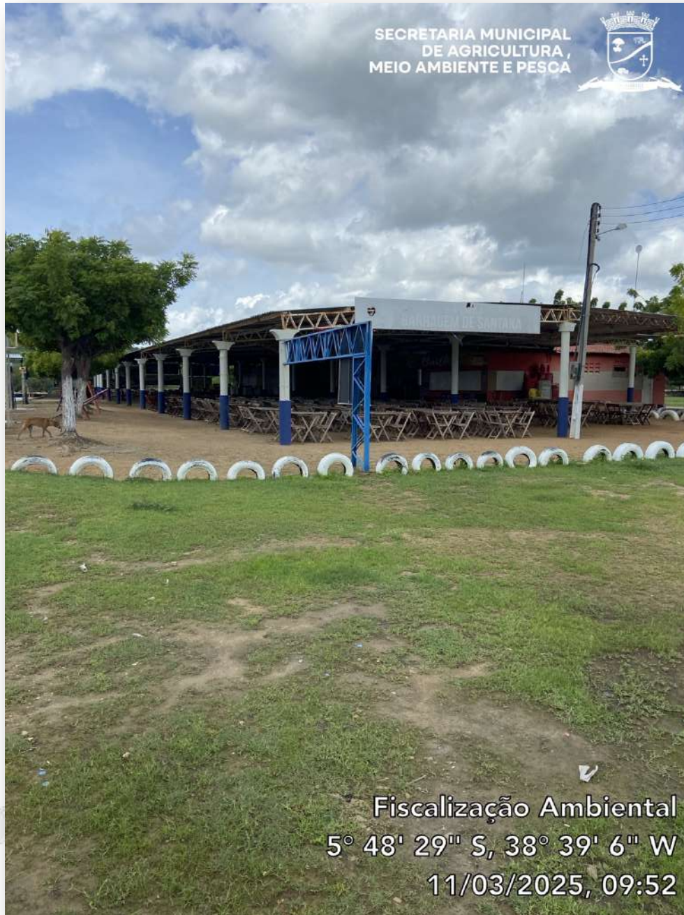
Figura 5 - Visão aproximada do galpão, evidenciando pilares de concreto e estrutura metálica de cobertura
