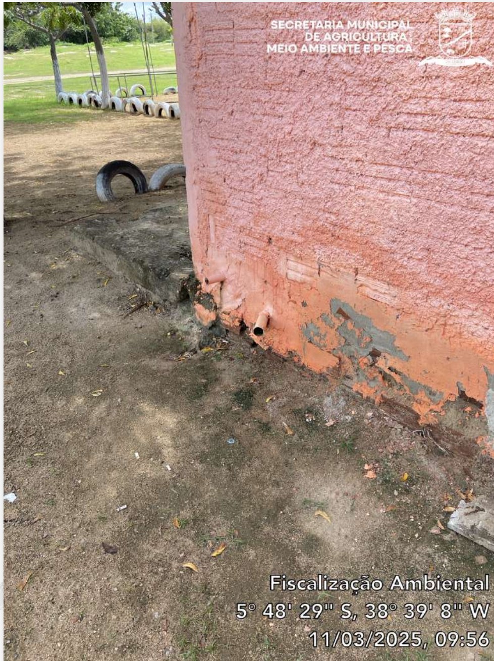
Figura 9 - Tubulação exposta, sem destino a qualquer tipo de tratamento, seja caixa de gordura, sabão ou fossa séptica
